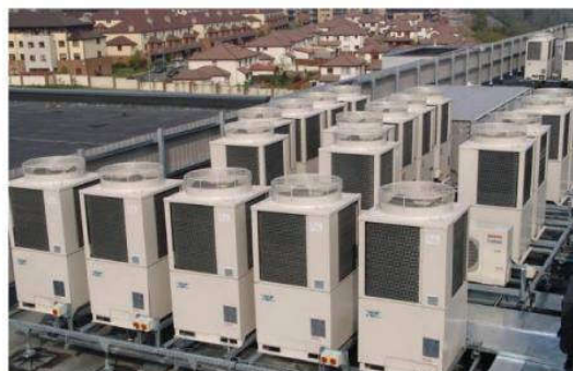
Hệ thống điều hòa trung tâm thông minh (VRV, VRF) Central intelligent air-con system (VRV, VRF)
