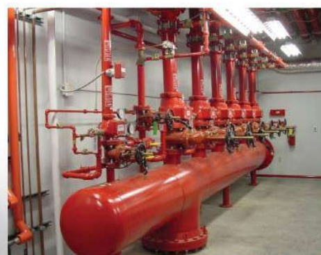
Hệ thống chữa cháy Foam Foam fire fighting system
