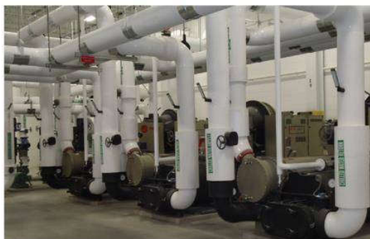
Hệ thống chiller (giải nhiệt gió, nước) Chiller system (both air cooled and water cooled)
