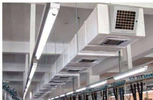
Hệ thống thông gió Ventilation system
