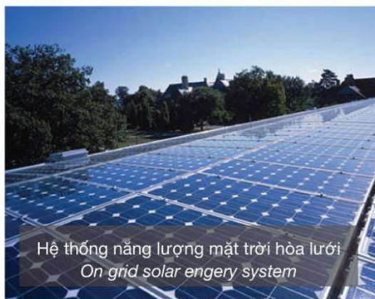
Hệ thống năng lượng mặt trời cho trạm BTS Solar energy system for BTS
