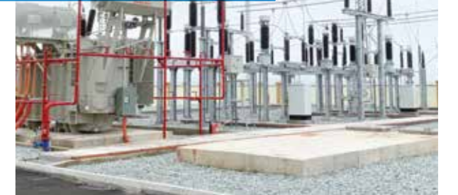
DỰ ÁN ĐIỆN GIÓ PHƯỚC HỮU - DUYÊN HẢI 1 [30MW] - NINH THUẬN 30MW PHUOC HUU - DUYEN HAI 1 WIND POWER PROJECT - NINH THUAN GÓI/PKG: THI CÔNG TRẠM BIẾN ÁP VÀ ĐƯỜNG DÂY 220KV SUBSTATION AND TRANSMISSION LINE 220KV
