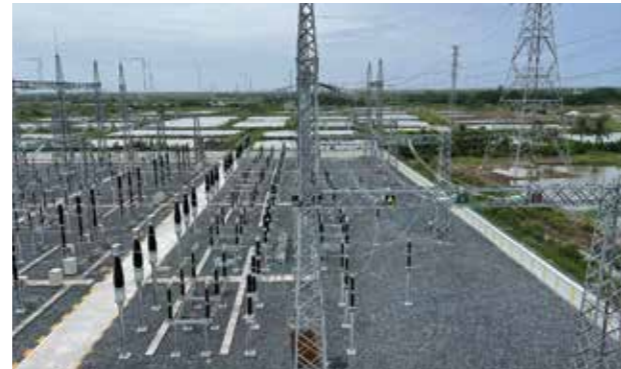
TRẠM BIẾN ÁP 220KV TẠI DỰ ÁN ĐIỆN GIÓ HÒA ĐÔNG 2 - SÓC TRĂNG 220KV SUBSTATION AT HOA DONG 2 WIND POWER PROJECT - SOC TRANG
