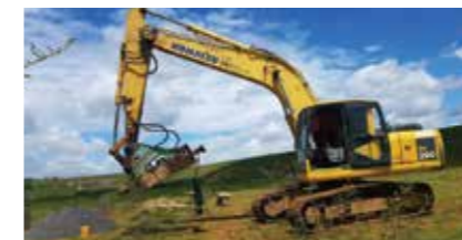
Máy đóng cọc móng giá đỡ tấm pin Foundation piling machine of PV panel bracket
