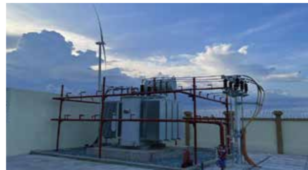
TRẠM BIẾN ÁP 110KV TẠI DỰ ÁN ĐIỆN GIÓ PHƯỚC HỮU DUYÊN HẢI 1 - NINH THUẬN 110KV SUBSTATION AT PHUOC HUU DUYEN HAI 1 WIND POWER PROJECT
